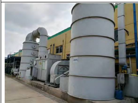
3#废气处理装置
