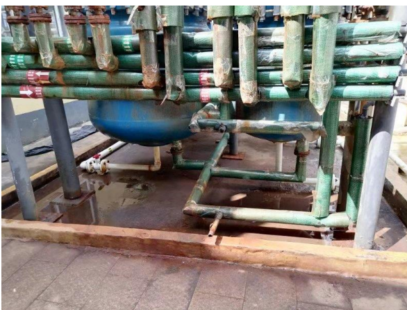
物料输送管道
